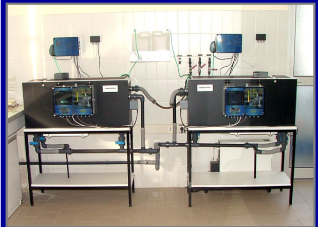
Ici un exemple d'installation de deux systèmes visiolabs : une surveillance eaux brutes et une surveillance eaux filtrées (Station d'Aix en Provence – Saint-Eutrope)
