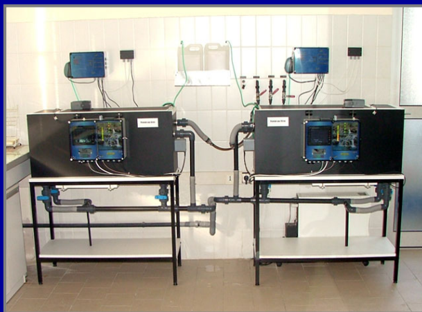
VEOLIA - Station d'Aix en Provence Saint-Eutrope - Surveillance eaux brutes et surveillance eaux filtrées
